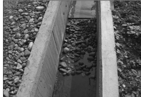
圖 11-26 桃園市新楊區小排水路-渠底滲水槽
