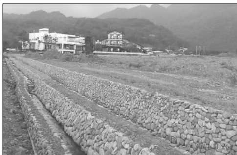
圖 11-21 宜蘭縣十六結區四稜砂岩乾砌石排水路
