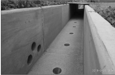
圖 11-25 雲林縣麥寮(一)區小排水路-渠底滲水孔
