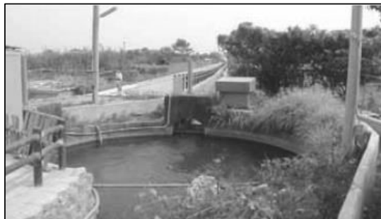
圖 8-12 台中農田水利會白冷圳分水池 2 號池
