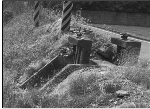
圖 9-12 彰化農田水利會路上圳北幹線定水頭孔口量水門
