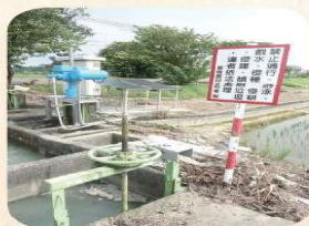
透過太陽能板提供水門開關電源。
