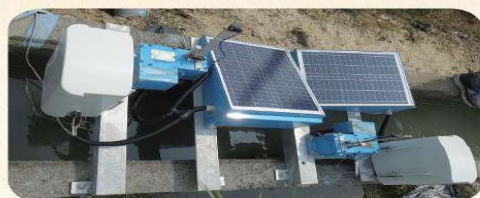
透過太陽能板提供水門開關電源。
