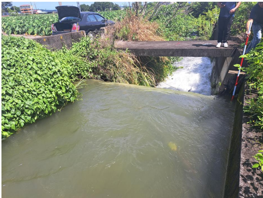
「穿龍圳北幹線小水力發電建置案」現地照片
